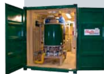
Centrala de abur in container
